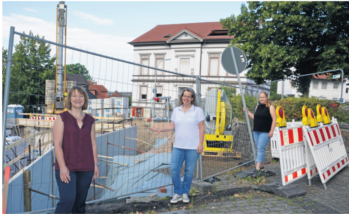
Auf das Neubauprojekt des Regenbogen-Kindergartens des KJU freuen sich Leiterin Christina Faßmann (v. li.), Trägervereinsvorsitzende Katrin Schlüter und Architektin Susanne Ebeling-Kranefuß.
